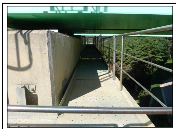
사진번호 48 교각 P5 점검통로 설치현황 외관망도 -
