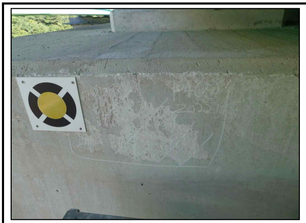
사진번호 43 교각 P4 전면 표면박리 외관망도 109-1
