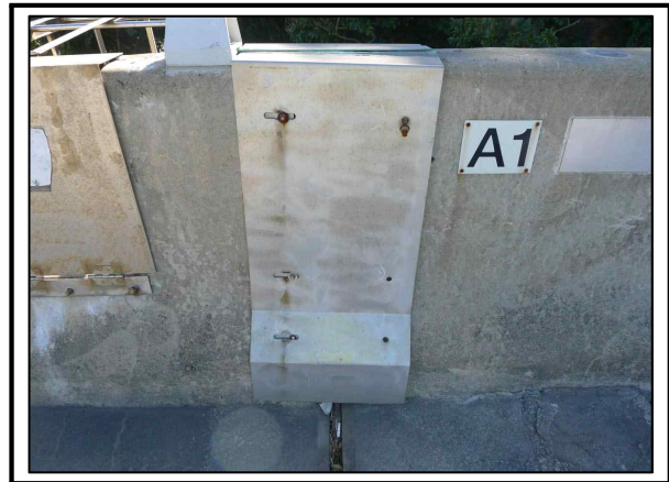
사진번호 20 신축이음 A1 차수판 볼트체결불량 외관망도 56
