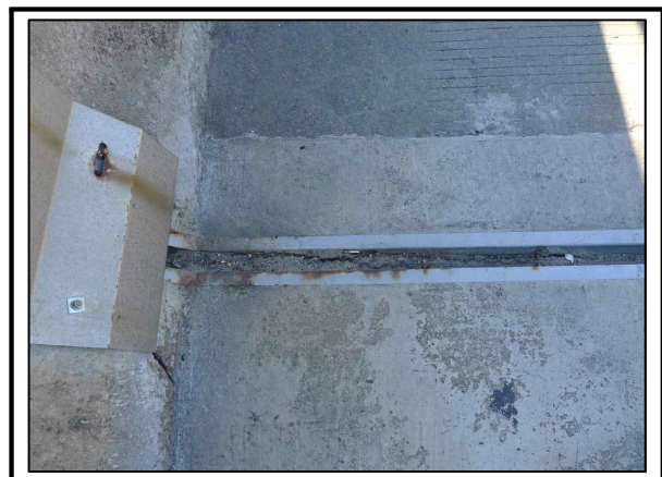
사진번호 22 신축이음 A2 유간부 토사퇴적 외관망도 61-1
