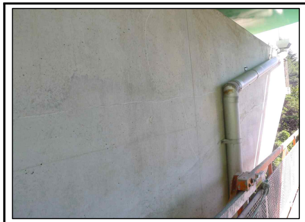
사진번호 44 교각 P5 배면 코핑부 균열(0.3mm이상) 외관망도 110-1
